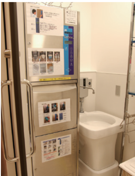
ベッドパンウォッシャーには、使い方を分かりやすく掲示している
